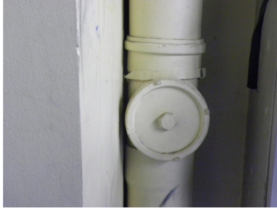
Tubería de evacuación agua lluvia en caso de emergencia
