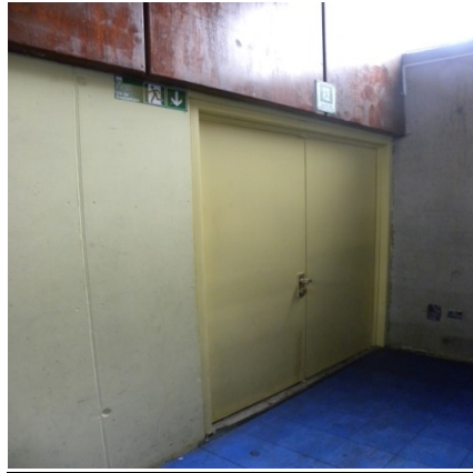
Salida de emergencia lateral zona oeste
