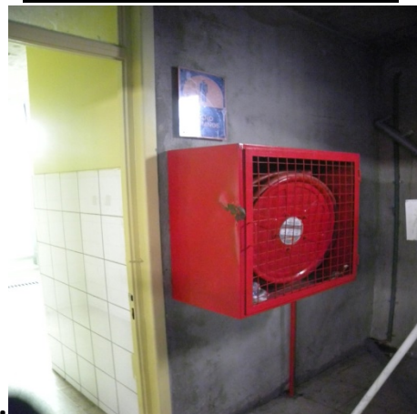
Red húmeda Manguera de incendio
