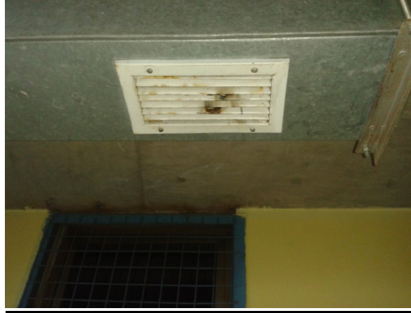
Evacuación de vapor de agua en camarines
