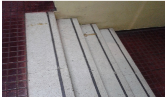
Escalera de ingreso con línea antideslizante
