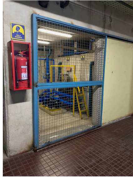
Bombas de agua en pasillo del subterráneo
