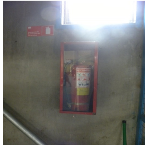
Extintor de incendio gimnasio
