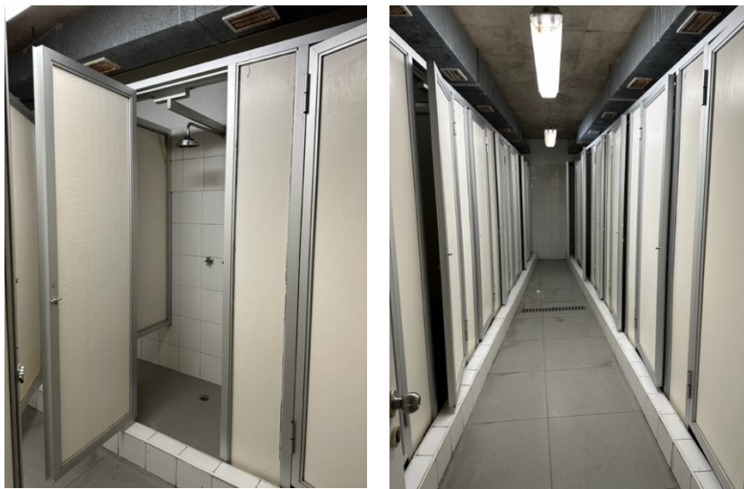
Camarines de damas con líneas antideslizantes en duchas damas y varones
